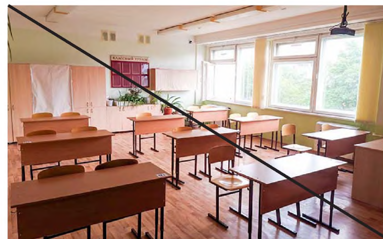
Плохо Линолеум под дерево
