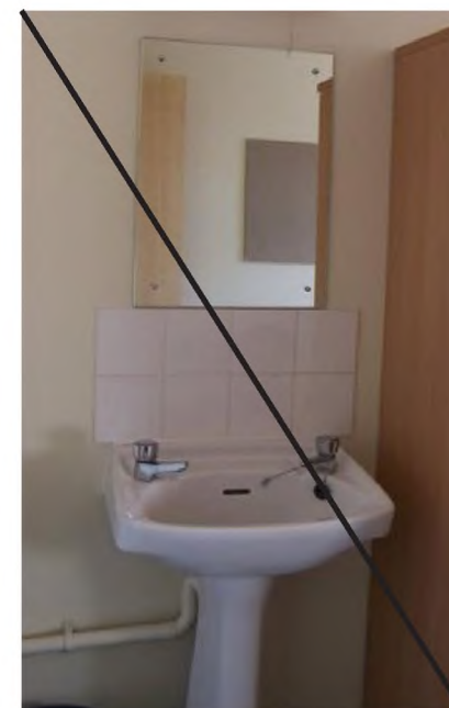
Плохо Раковина с пьедесталом. Фартук из плитки
